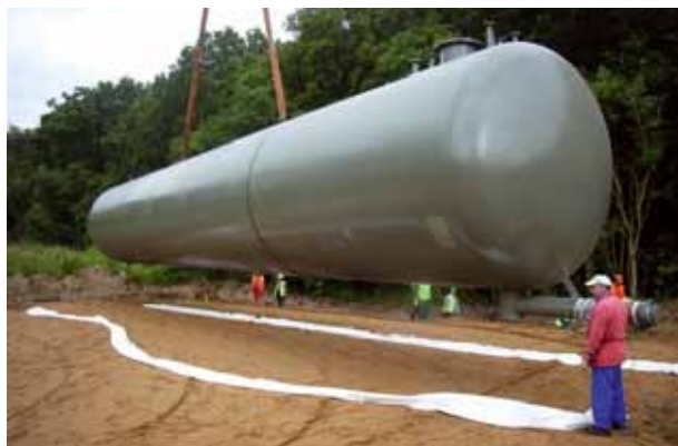
podzemní zásobníky na plyn
