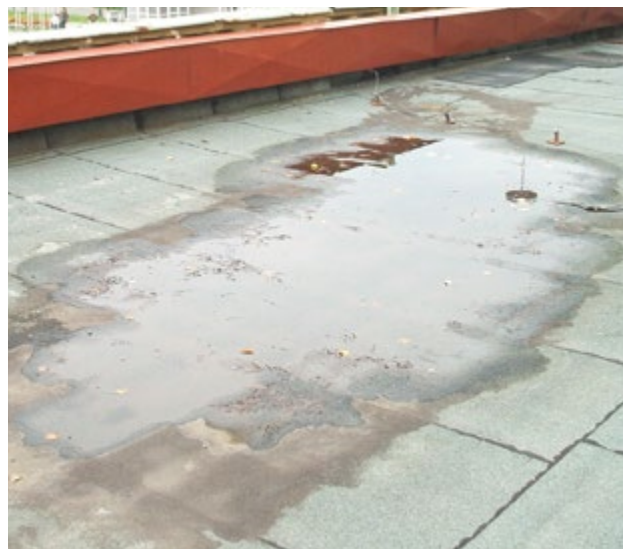
Nežádoucí kaluž vody na ploché střeše.
