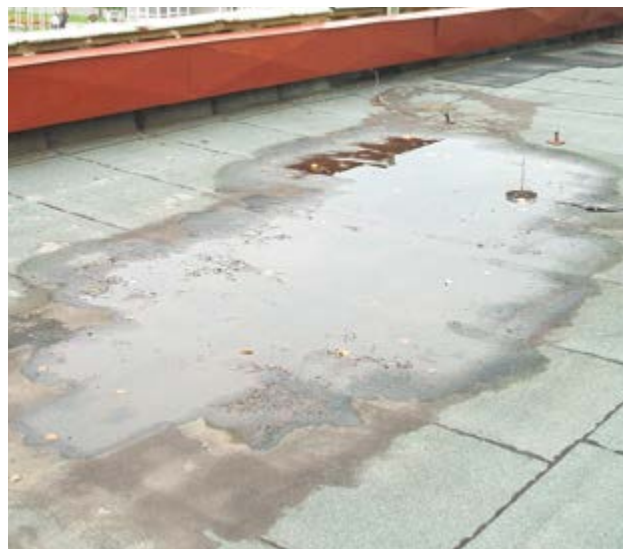
Nežádoucí kaluže vody na ploché střeše.
