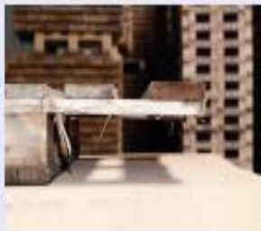
Chybějící konstrukční prvek
