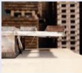
Chybějící konstrukční prvek
